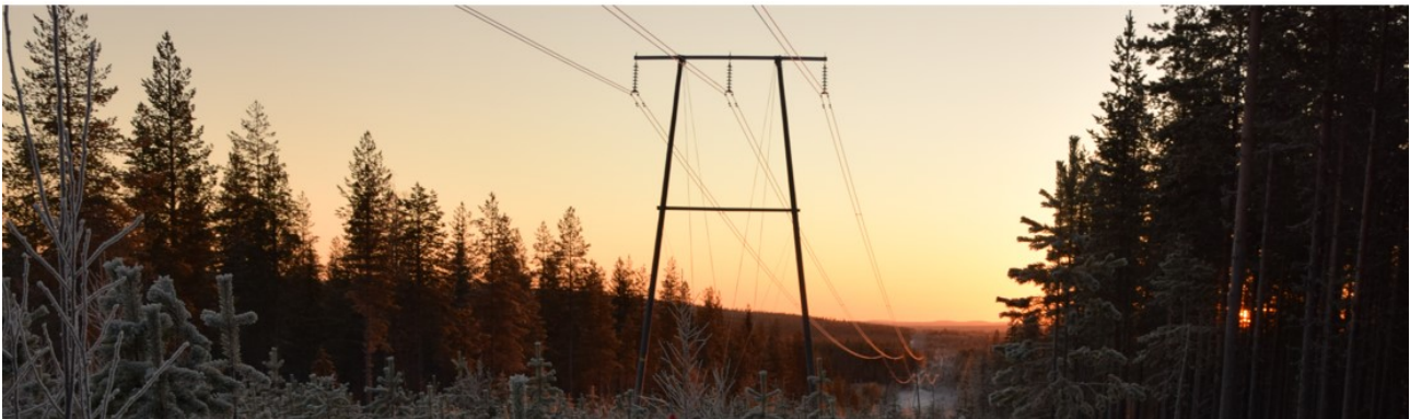
Ylisenvaaran sähkölinja, näkymä lounaaseen. Kuva Jarno Niskala 2021.
